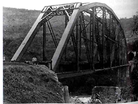
Fig. 4.- Puente paso interior, travesía compuesta de armadura de hierro remachado y articulado, tipo Parker, sobre estribos de mampostería. Fuente: CONACULTA/CNPPCF/CEDIF.
