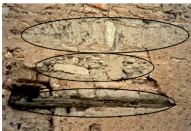
Figura 6. Vista de los sistemas de construcción sobre el dintel de una puerta Nota: se puede apreciar la utilización de diferentes materiales constituidos por piedra, adobe, madera y tepetate. Fuente: fotografía propiedad del autor.
