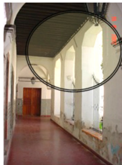
Figuras 14 a y b. Confrontación de la tipología de las ventanas de los corredores del patio principal de los conventos franciscanos de Charcas y San Luis, respectivamente
