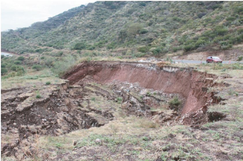
Figura 4. Colapso de taludes en libramiento por desvío de cauces de agua. Fotografía tomada por el autor.
