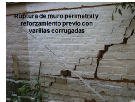
Imagen 8. Daños en muros de lindero.
