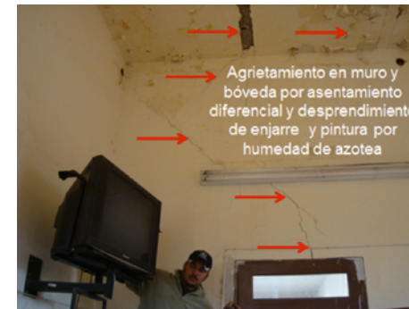
Imagen 14. Daños en escuelas.
