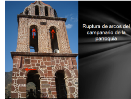
Imagen 12. Daños en edificios públicos.
