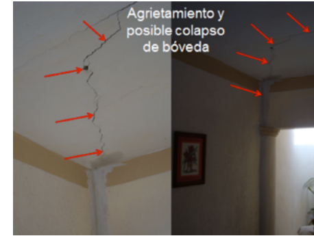
Imagen 13. Daños en techos de viviendas.
