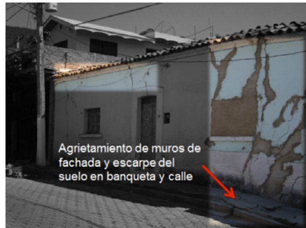
Imagen 5. Daños en vialidades y fachadas.
