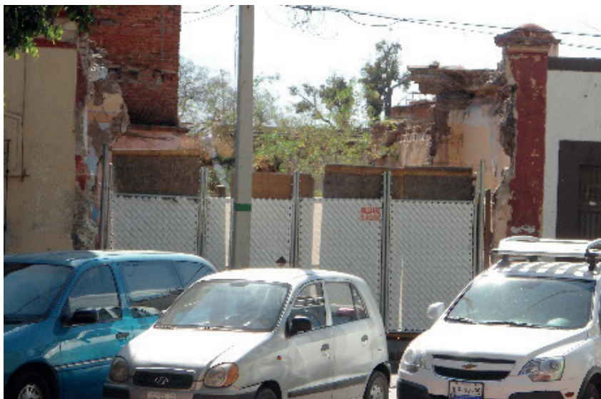
Gráfico No. 5. Inmueble ubicado en Río de la Loza Sur No. 26, Centro, uso actual: pérdida del inmueble, quedan algunos vestigios de muros al interior, 80% del inmueble fue demolido.
